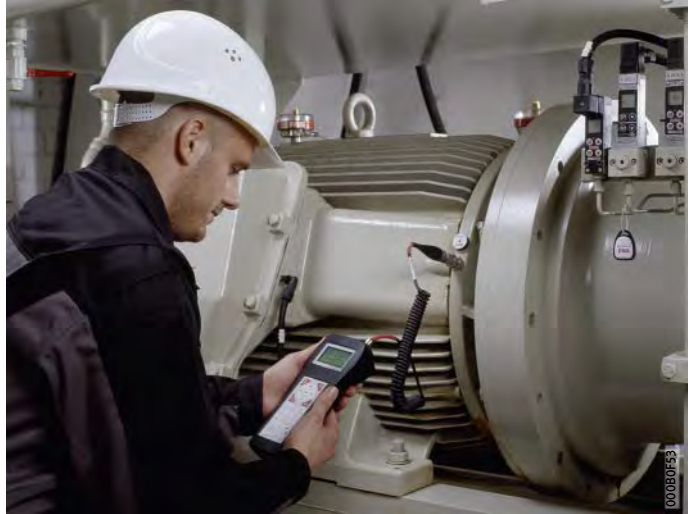
Bild 14 Selbstständige Prüfung des Maschinenzustands
