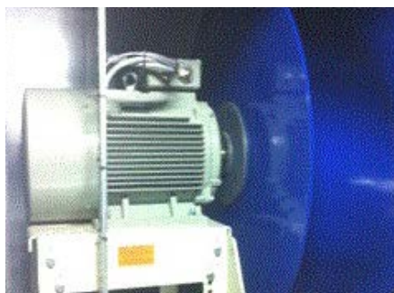
Hauptlüfter mit Motor
