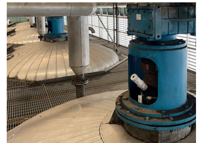
Schmierstoffgeber OPTIME C1 und OPTIME CM überwachen Mischwerk
