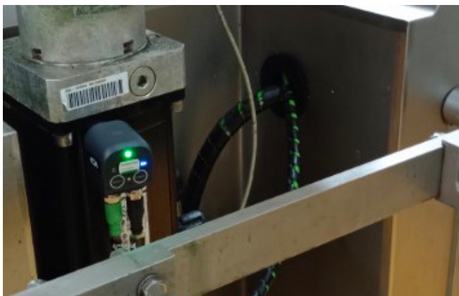
SmartCheck am Servomotor installiert.
