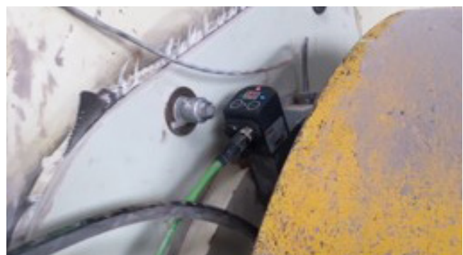
SmartCheck am Lagergehäuse installiert
