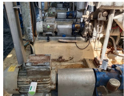
Capteurs OPTIME sur des pompes
