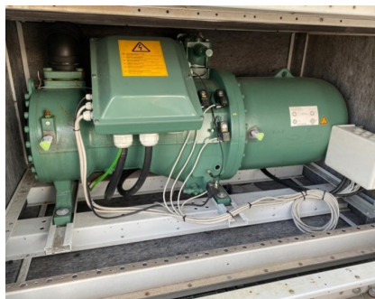
Capteurs OPTIME sur un compresseur de refroidissement
