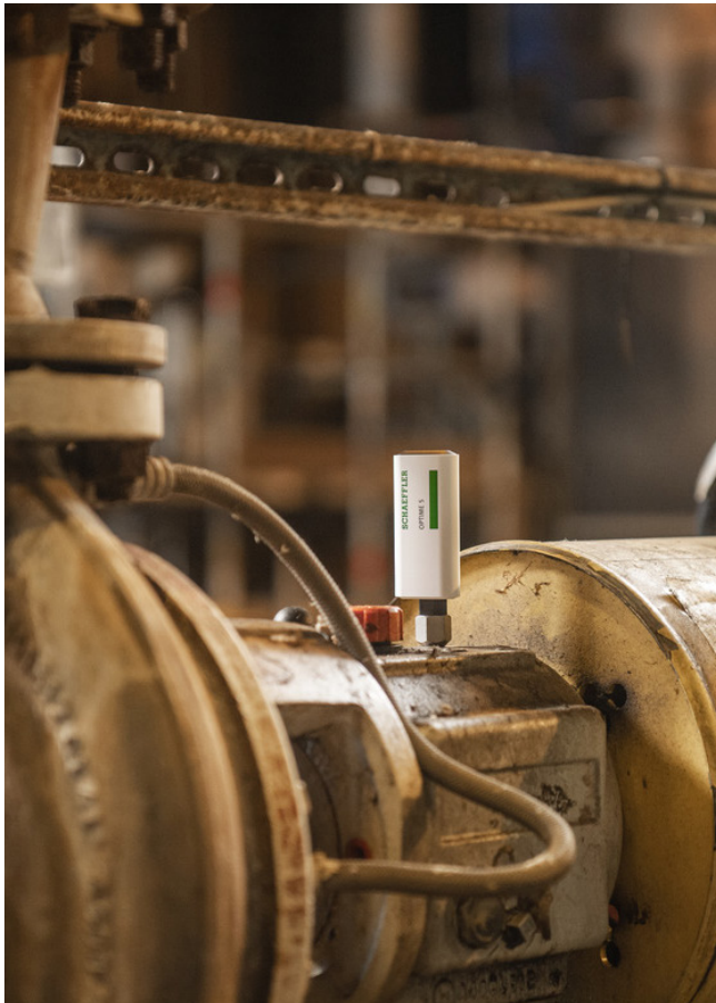
OPTIME-Sensor an einer Pumpe
