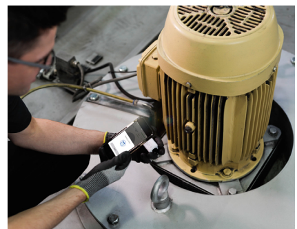
La información sobre el estado de las máquinas se visualiza en el teléfono inteligente.
