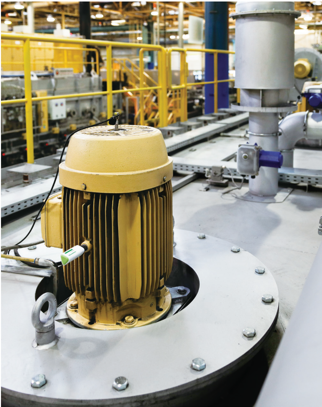
快速安装：施韦因富特的舍弗勒硬化车间利用 OPTIME 监测设备。
