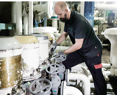
舍弗勒 OPTIME 安装在供气室内。
