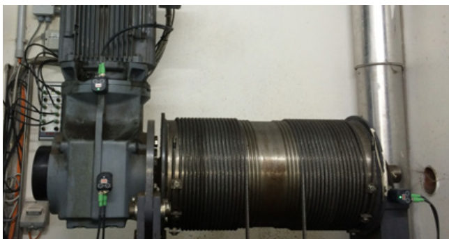
Drei SmartCheck sorgen für eine sichere Alarmierung am Palettenheber (hier noch im alten FAG Design)
