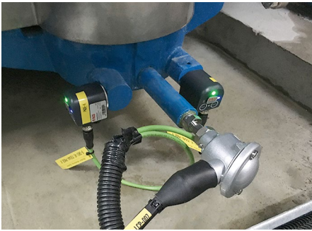
SmartChecks überwachen alle wichtigen Aggregate der Pumpstationen
