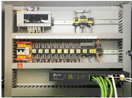
Für den Kunden wurde ein individuelles Layout der Schaltschränke entsprechend seiner Anforderungen vom Systemintegrator erstellt.
