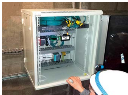
Schaltschrank mit SmartController
