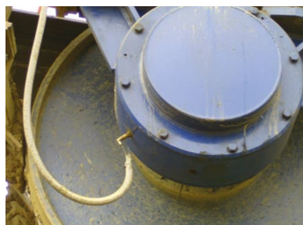
Schmierstoffanschluss am Bandtrommellager
