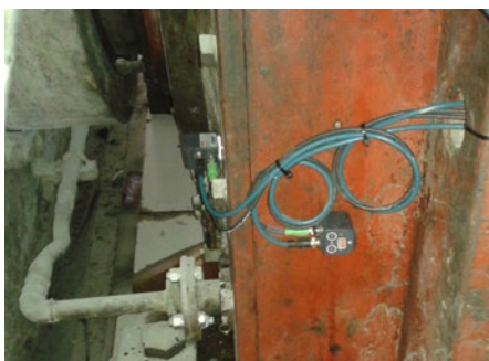
Vorübergehende Zustandsüberwachung des antriebsseitigen Zapfenlagers durch zwei FAG SmartCheck-Systeme
