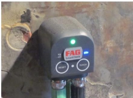
Überwachung der Mahlwalzenlager mit dem FAG SmartCheck
