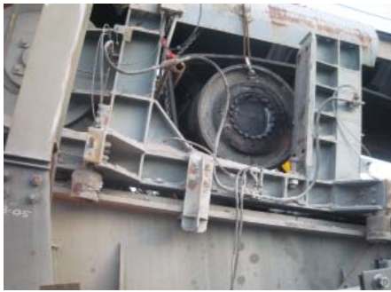
Schaden an der Spann-Umlenktrummel
