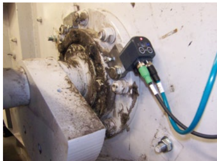
Der FAG SmartCheck im Einsatz an einem Schwingsieb
