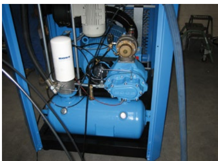
Monitorización de un compresor de hélice de la empresa Boge
