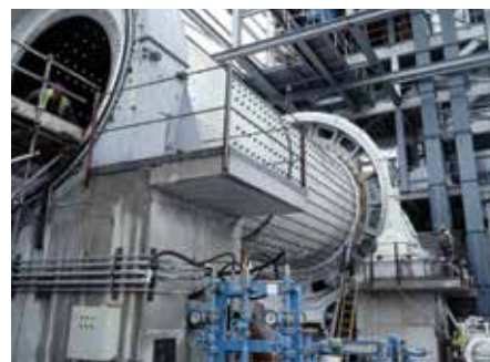
Rohrmühle in der Zementindustrie
