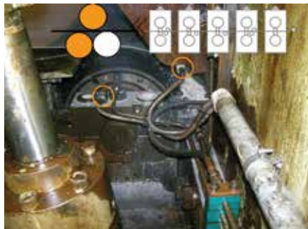
Sensoren am Dreiroller einer Tandemstraße im Kaltwalzwerk
