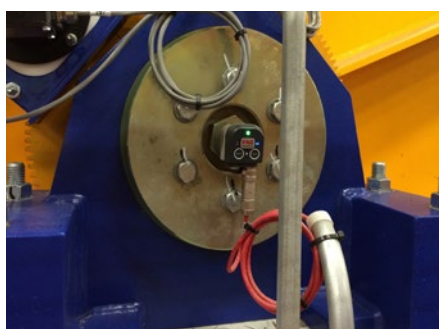
Überwachung der Antriebselemente durch den FAG SmartCheck
